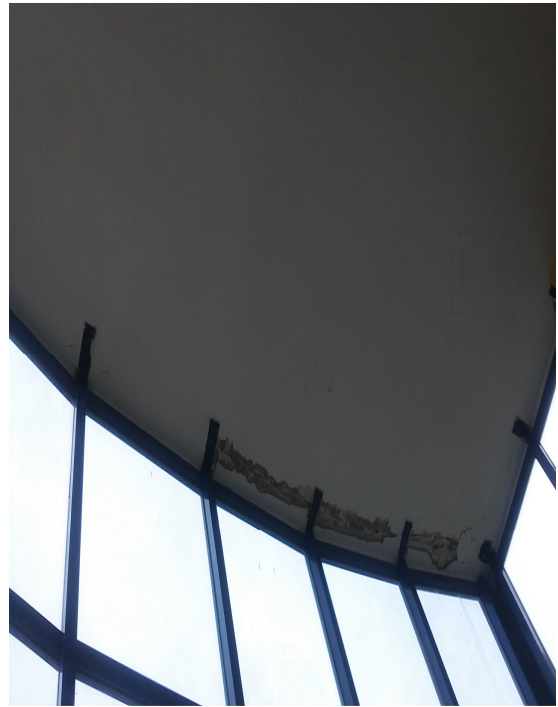
FILTRACION EN CUBIERTA
