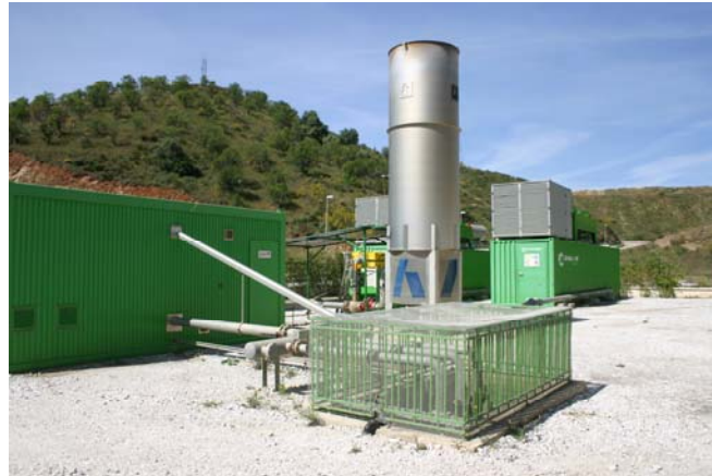
Planta de desgasificación y aprovechamiento eléctrico
