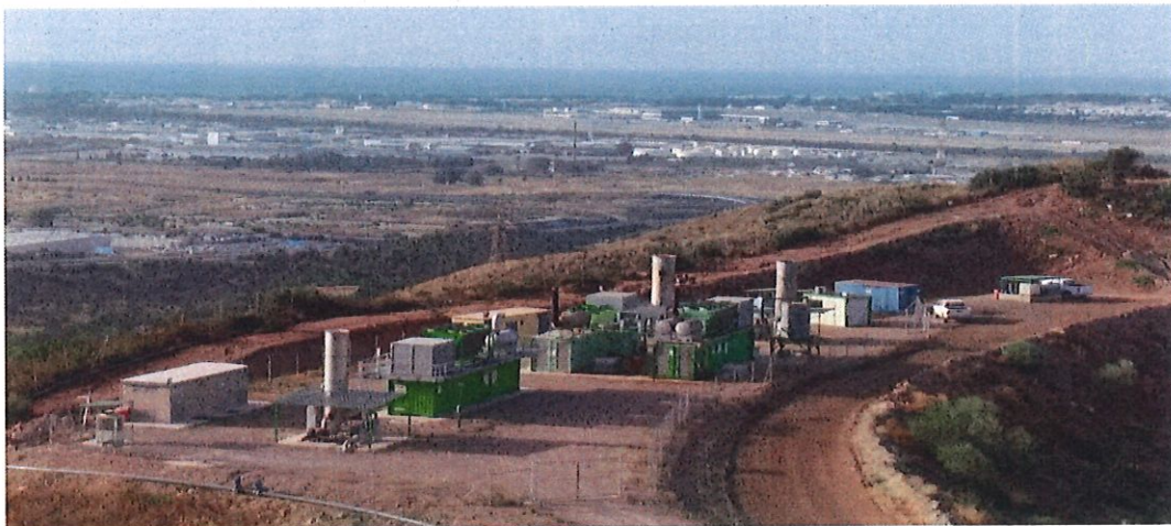
Planta de desgasificación y aprovechamiento eléctrico
