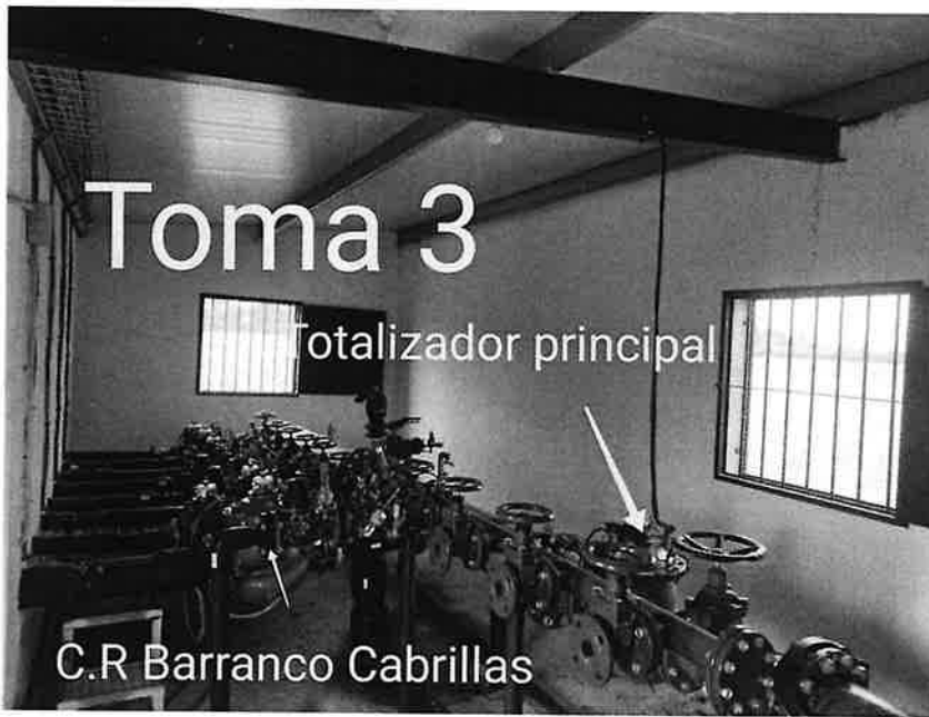
Toma de Riego "Toma 3"
