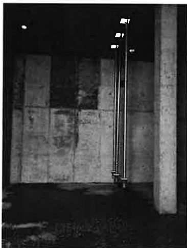
Aspiración de las bombas del depósito
