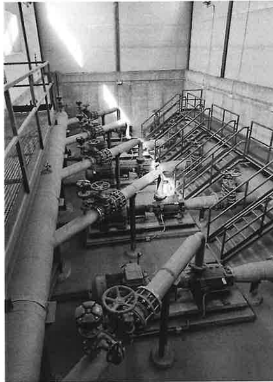
Estación de Bombeo EDAR Rincón de la Victoria
