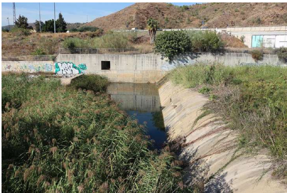
Imagen 12: Vertido aguas debajo de la primera rápida. Fuente: Google Earth
