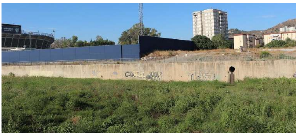
Imagen 31: Vertido en margen derecha
